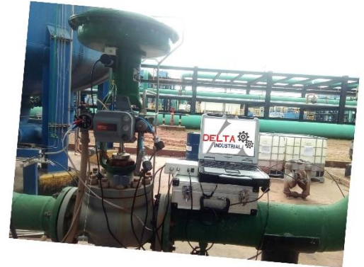
Diagnostico de Valvulas de Control
