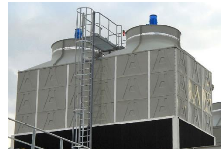
Torres de enfriamiento
